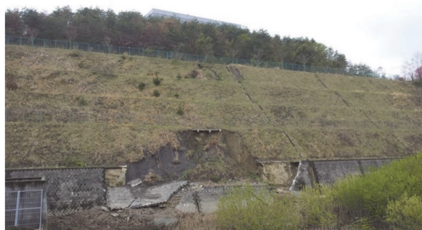
図 1. 第 1 ドッグランに面した調整池斜面の崩落 (RK 撮影)
